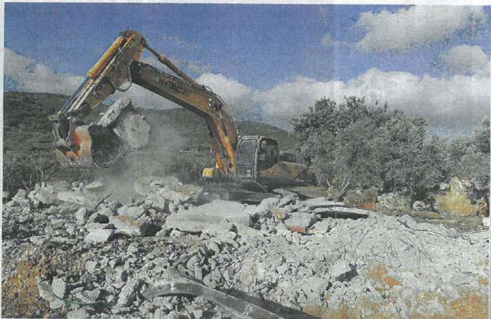
הריסה של מבנה לא חוקי ביישוב כליל. העונש בגין בנייה ללא היתר – עד שנתיים מאסר צלול: רחי שלוש
